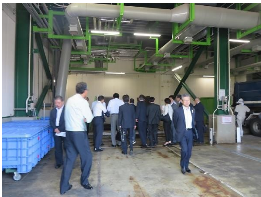
受入・前処理設備
