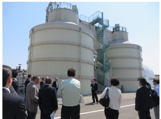
メタン発酵槽
